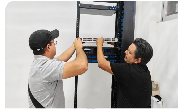
Instalación de switch
