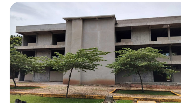
Edificio de aulas de la Unidad Académica de Medicina Veterinaria y Zootecnia
