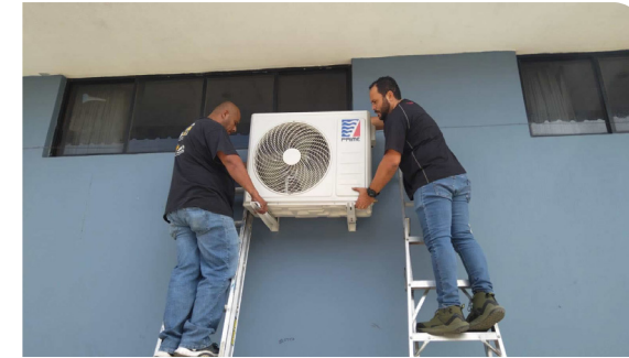
Mantenimiento de aires acondicionados
