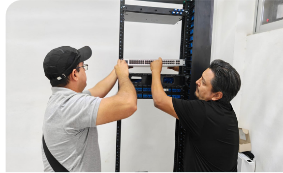
Instalación de switch
